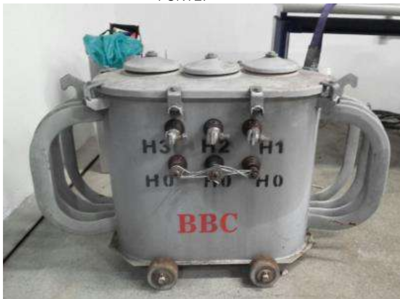
FIGURA 18 – TRANSFORMADOR TRIFÁSICO UTILIZADO COMO IMPEDÂNCIA DA FONTE.
